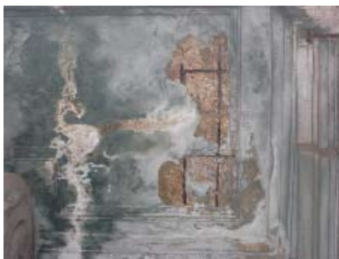
图2 保安洋行裸露的钢筋混凝土结构
